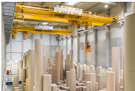
41540- 92: Das Papierrollenlager bei Blue Paper verfügt über eine Kapazität von über 15.000 Tonnen.
